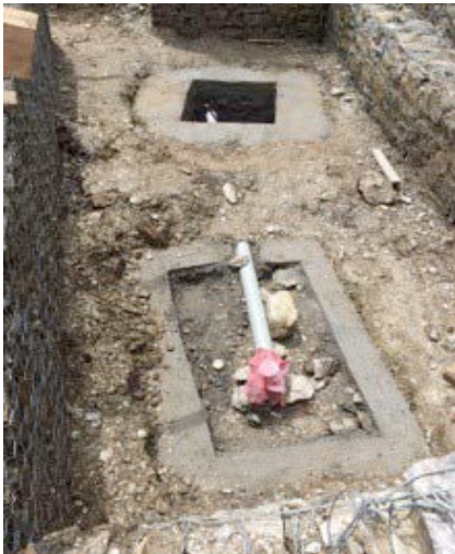
Toilettes et fosse sceptique
